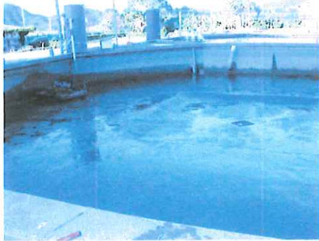
ヘドロの堆積は見られない・コンクリートが露出
